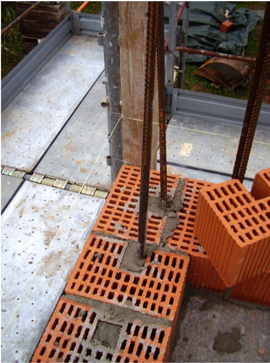
Fagagna: particolare della muratura armata.
