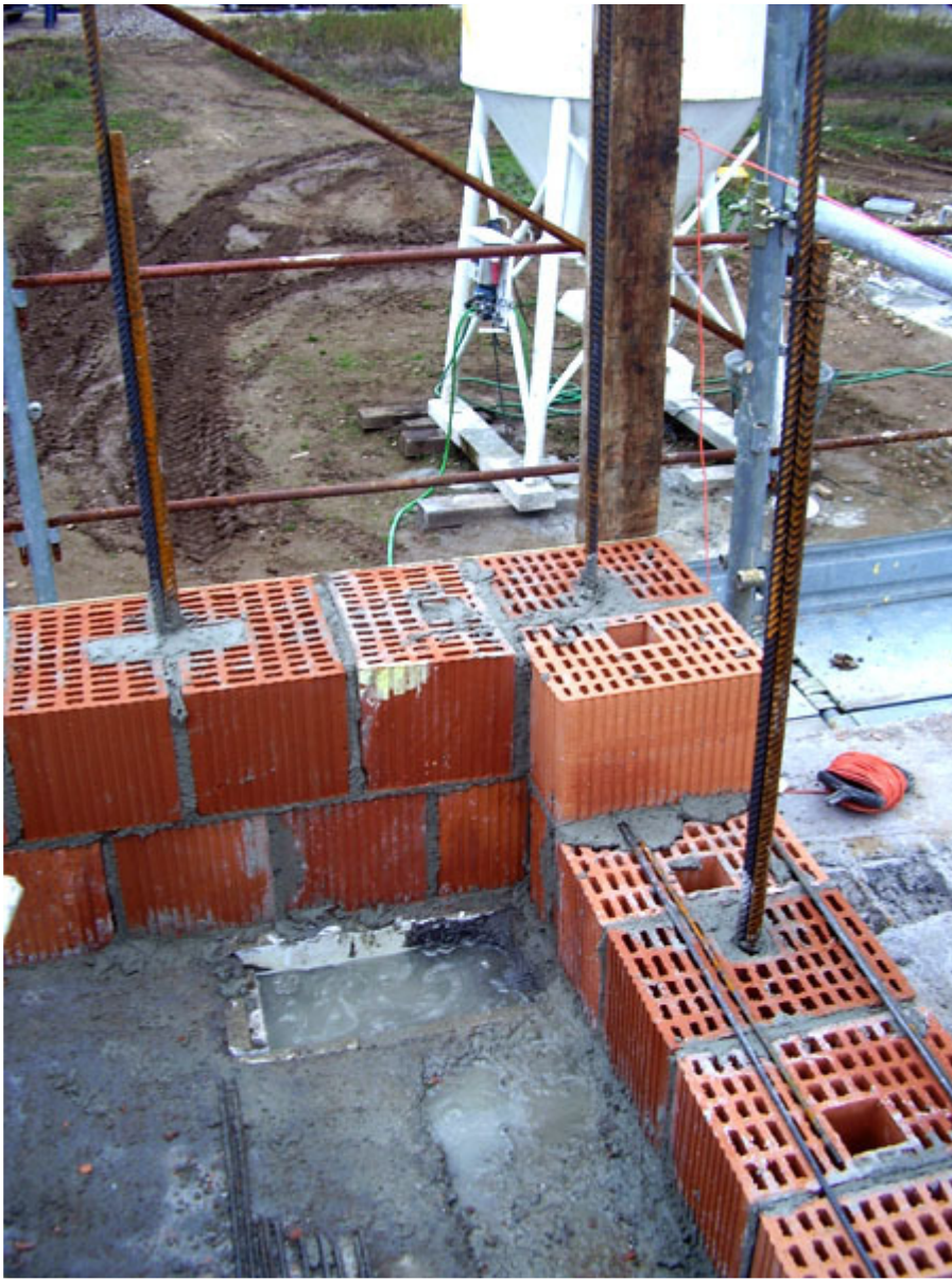
Fagagna: particolare della muratura armata.
