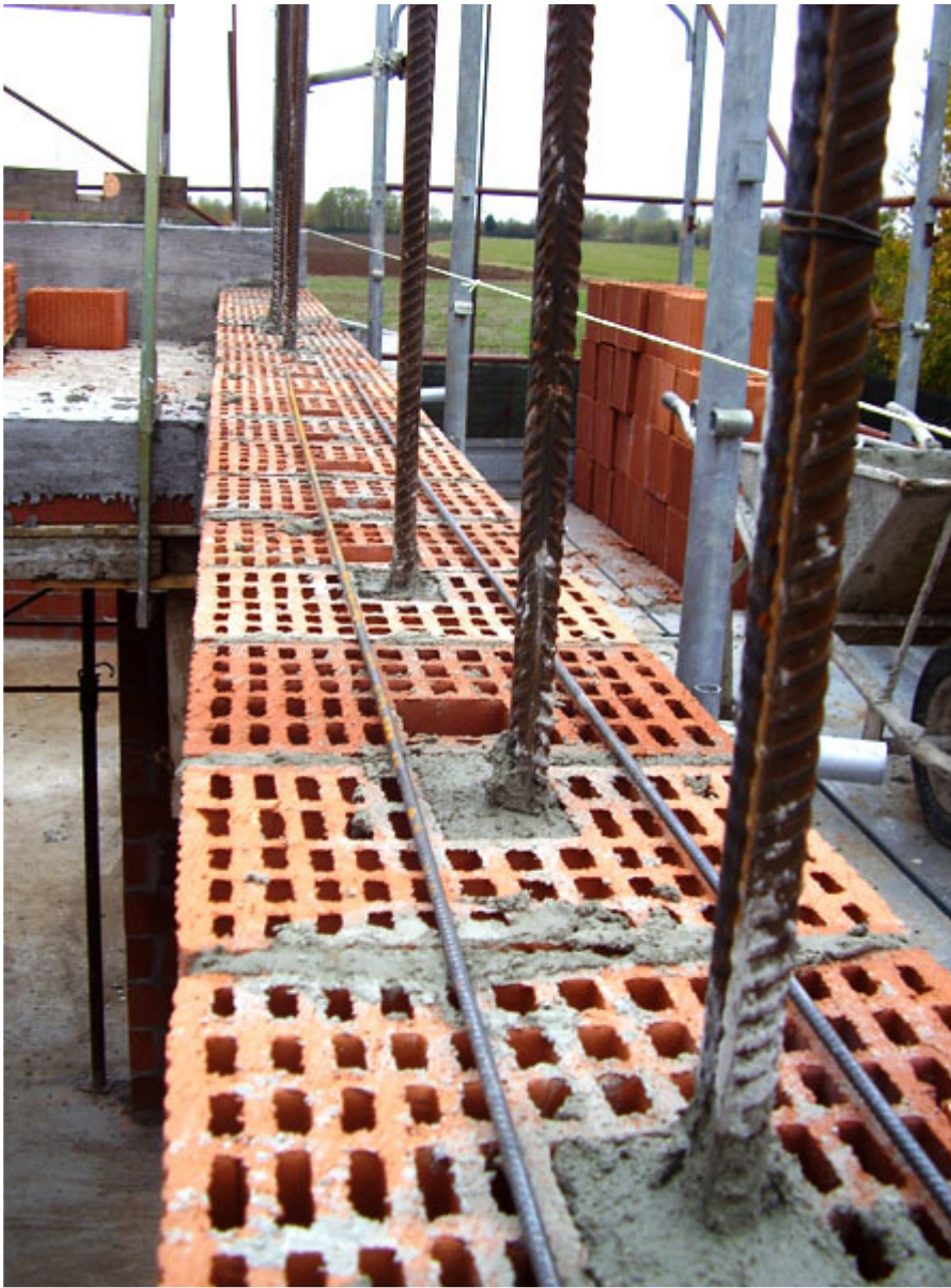
Fagagna: particolare della muratura armata.
