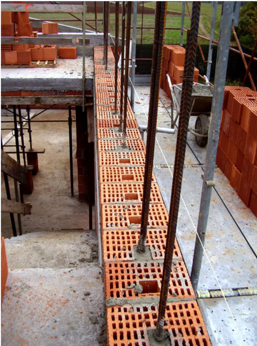
Fagagna: particolare della muratura armata.
